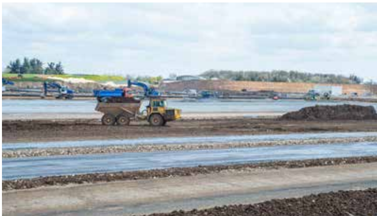
Travaux et inauguration d'une nouvelle piste d'atterrissage dédiée aux porteurs multirôles A330 MRTT Phénix sur la base aérienne d'Avord.
