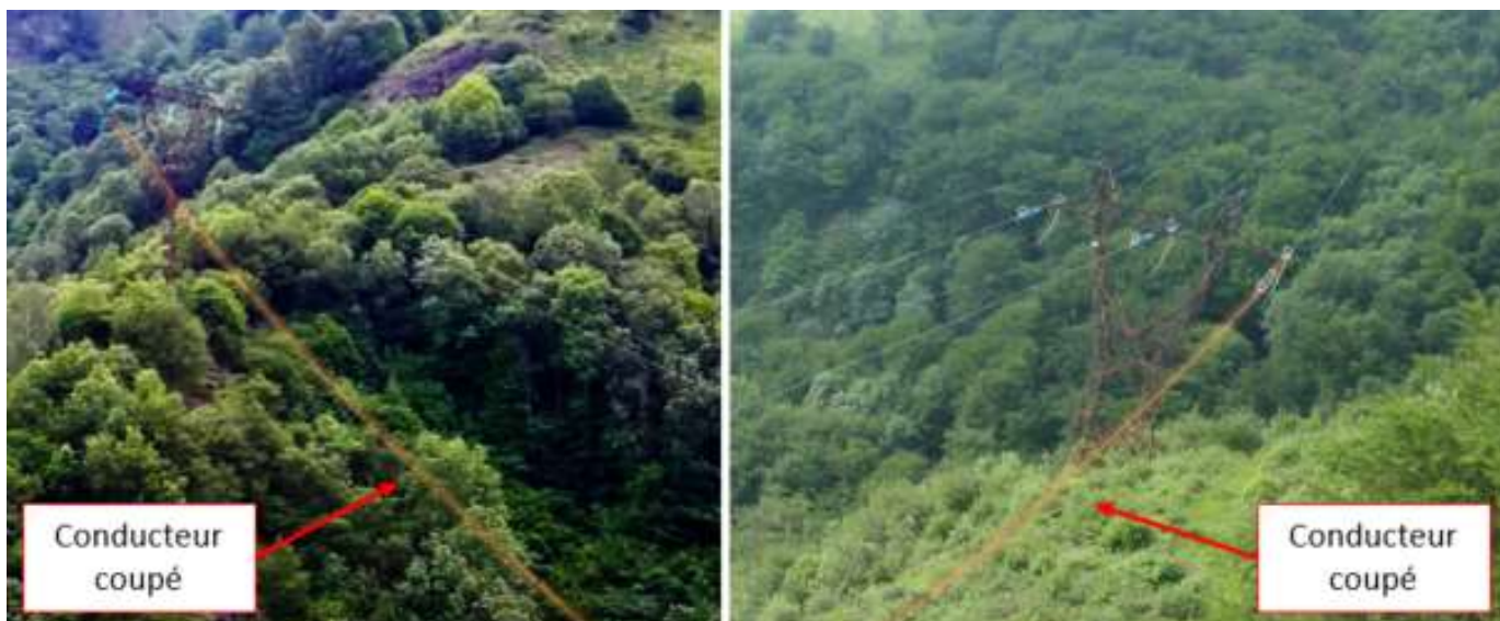
Figure 6 : pylônes est et ouest avec conducteurs coupés (surlignés)
