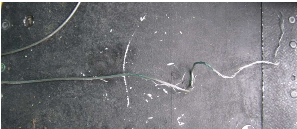
Figure 5 : dernier mètre du morceau de câble rompu
