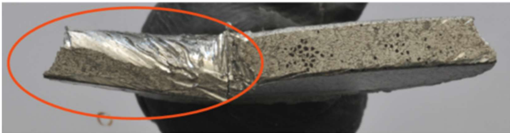
Figure 15 : traces de frottement du câble sur le morceau de flasque rompu
