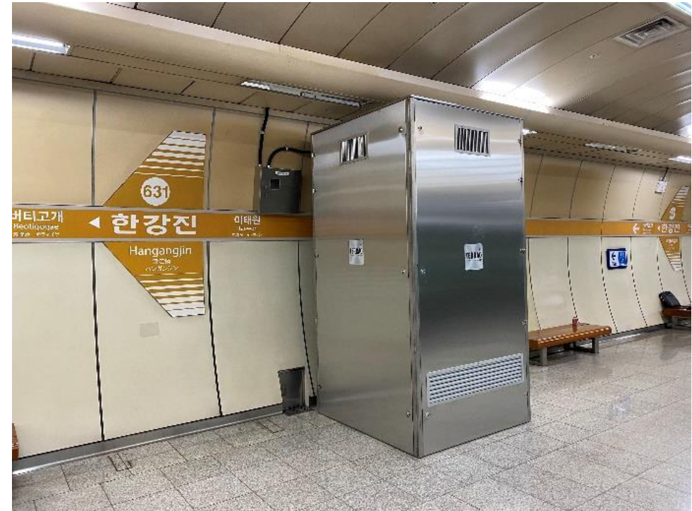
Crédits : STARKLAB - Usage d'un échangeur TERRAO dans le métro de Séoul pour capter les particules fines de l'air
