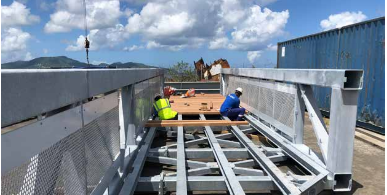
MONTAGE DE LA PASSERELLE FIXE EN JUILLET 2019 DU NOUVEAU QUAI FLOTTANT DU QUAI BEACHING À LA BASE NAVALE, POUR L'ACCUEIL DU BÂTIMENT DE SOUTIEN ET D'ASSISTANCE OUTRE-MER (BSAOM) DUMONT D'URVILLE ET DU PATROUILLEUR ANTILLES-GUYANE (PAG) LA COMBATTANTE, LIVRÉ EN OCTOBRE 2019, POUR ENVIRON 600k€@A.-G. TARI COQUELET - SID
