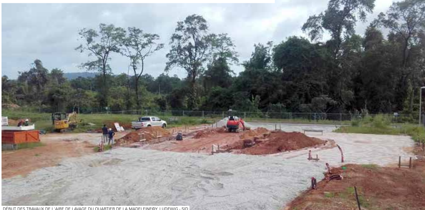
DÉBUT DES TRAVAUX DE L'AIRE DE LAVAGE DU QUARTIER DE LA MADELEINE@Y. LUDEWIG - SID
