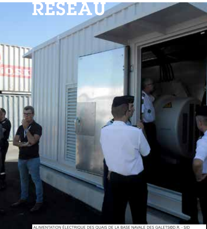
ALIMENTATION ÉLECTRIQUE DES QUAIS DE LA BASE NAVALE DES GALETS©D.R. - SID
