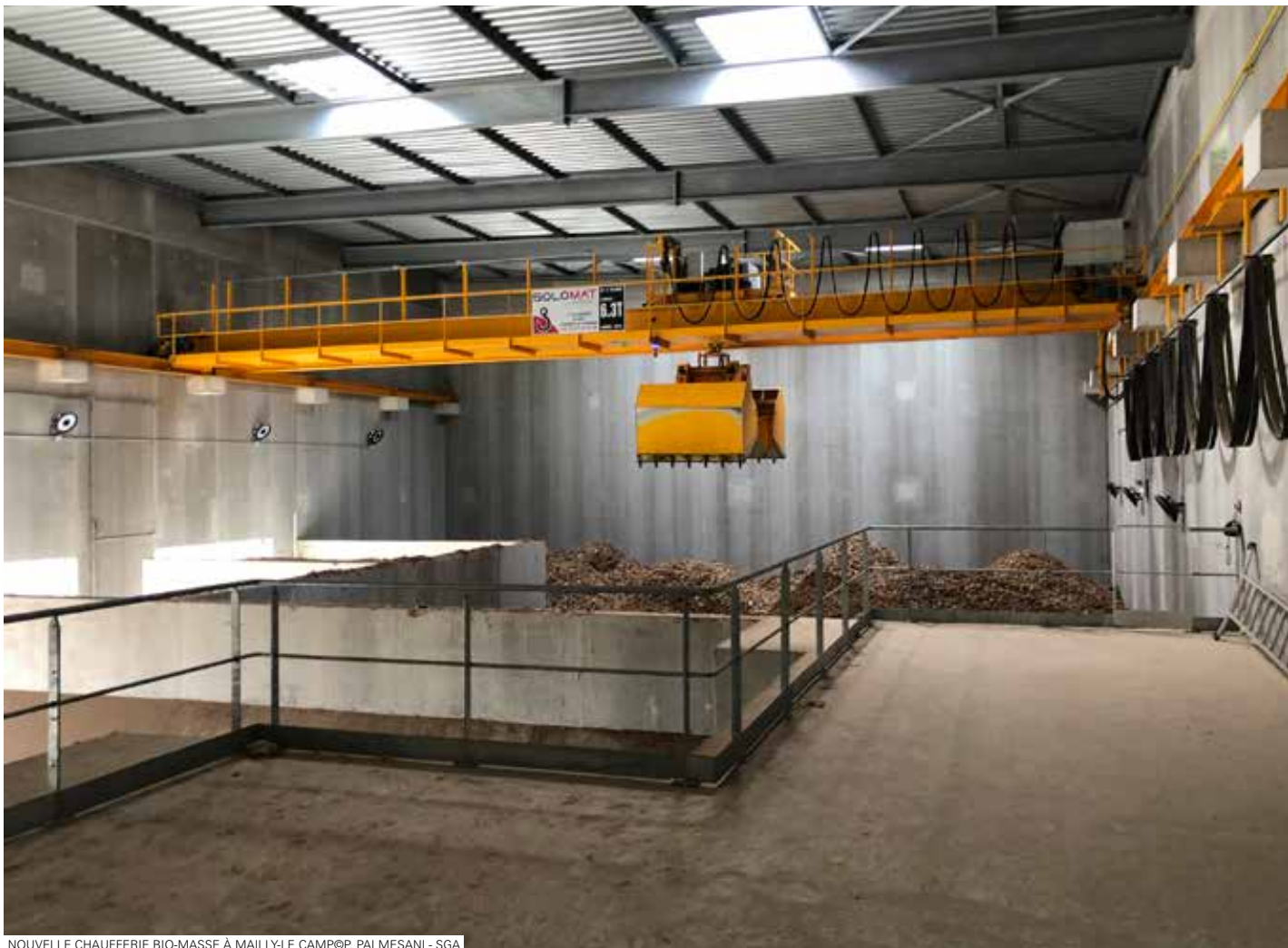
NOUVELLE CHAUFFERIE BIO-MASSE À MAILLY-LE CAMP. PALMESANI - SGA
