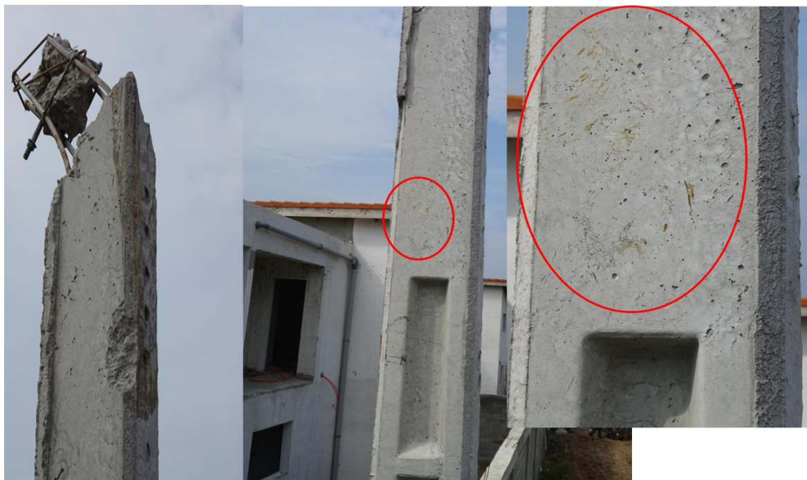
Figure 4 : poteau électrique endommagé
