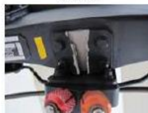
Rupture de l'attache
