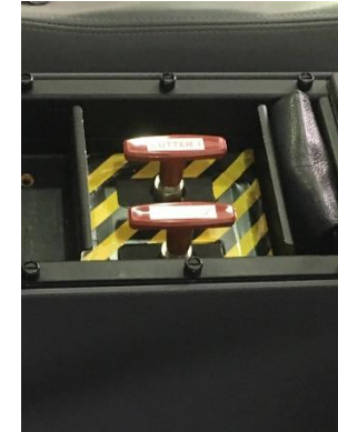
Couple cable (console centrale)
