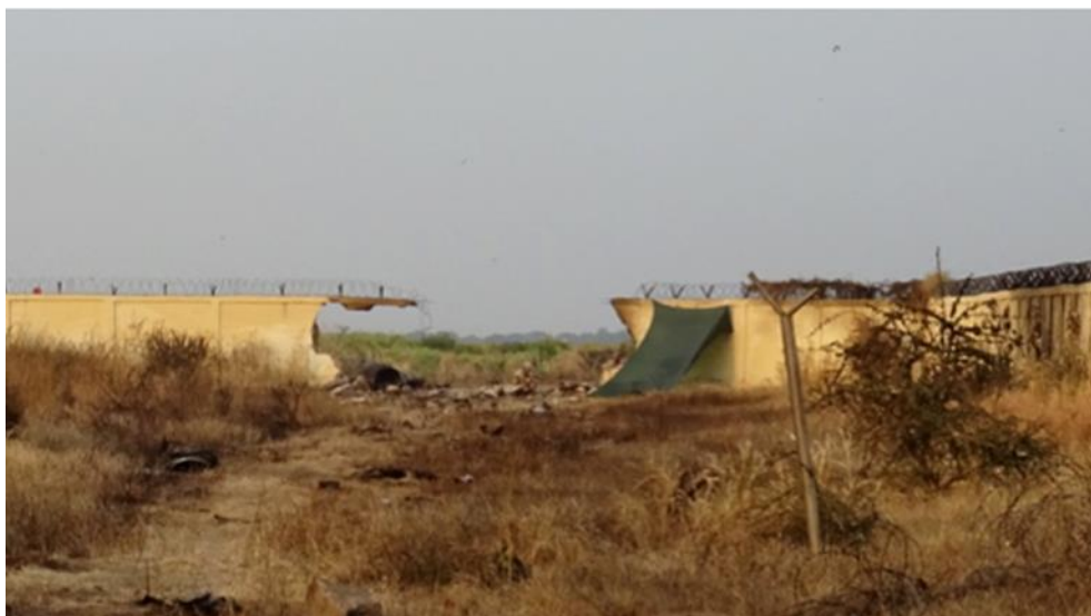
Figure 2 : brèche dans le mur d'enceinte vue de l'extérieur de l'aéroport
