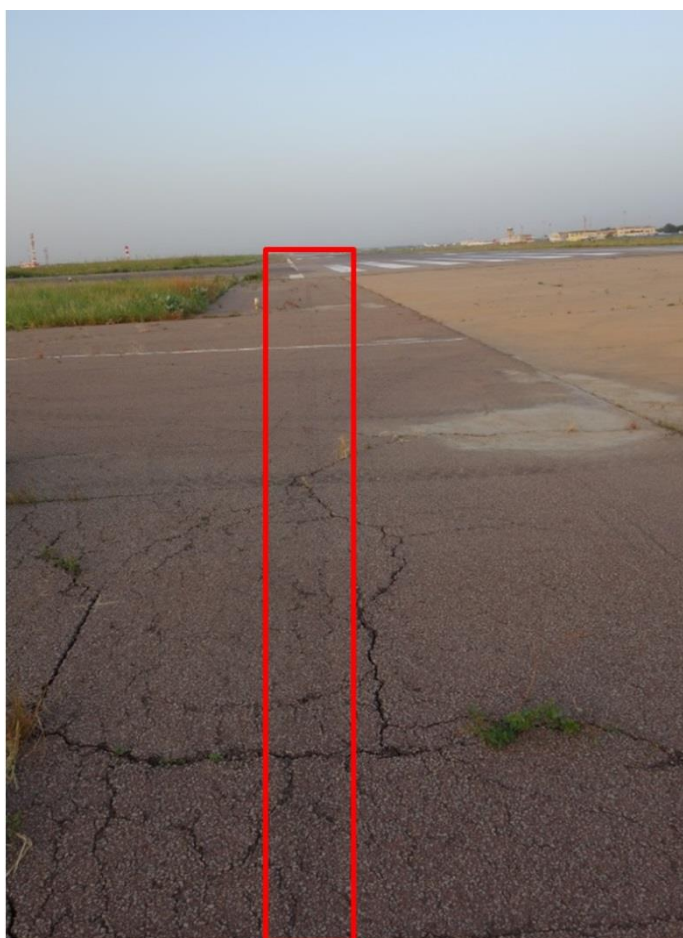
Figure 5 : trace de freinage du train principal droit
