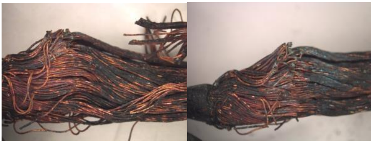
Figure 6 : brins sectionnés du câble
