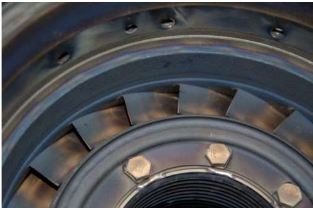
Criques en bord de fuite du distributeur turbine du 1 er étage
