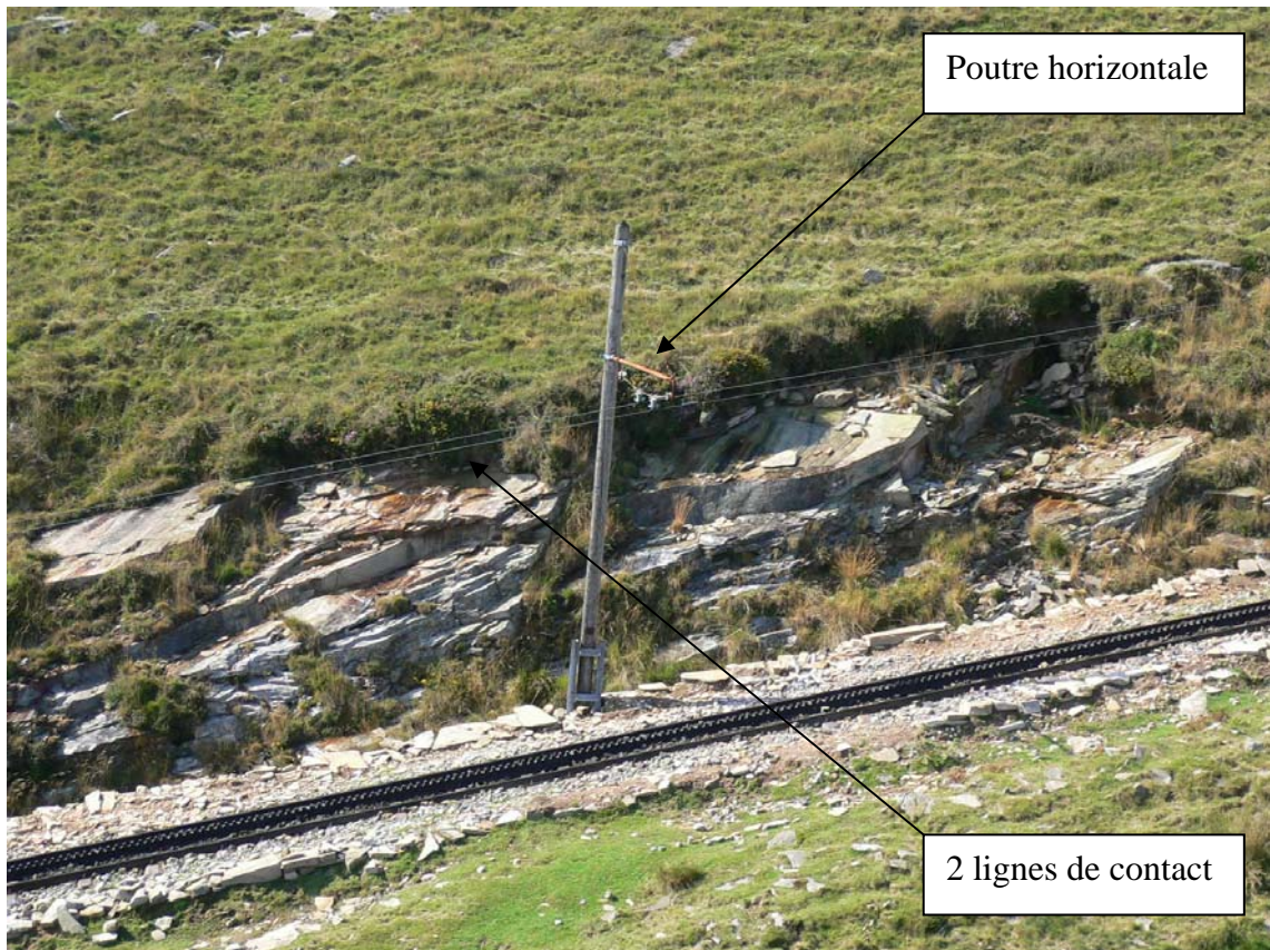
Figure 5 : Vue de l'alimentation électrique du train à crémaillère dans la zone de l'incident
