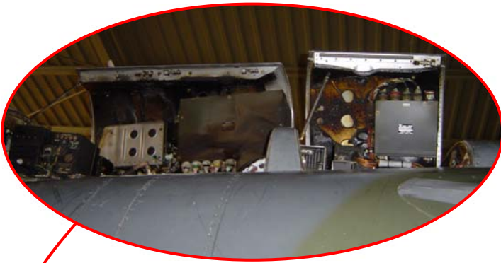
photo 1 : soutes à équipements avant et arrière
