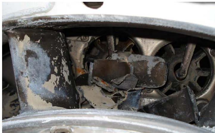
RM8 et RM9 en amont de la chambre de combustion
