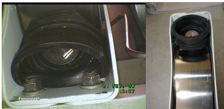
Corps étranger dans la caissette du TMU n°6
