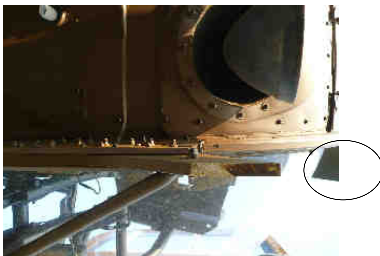
Vue n° 7 : traces de frottement sous le coupe-câble avant (l'avant de l'appareil est à droite)
