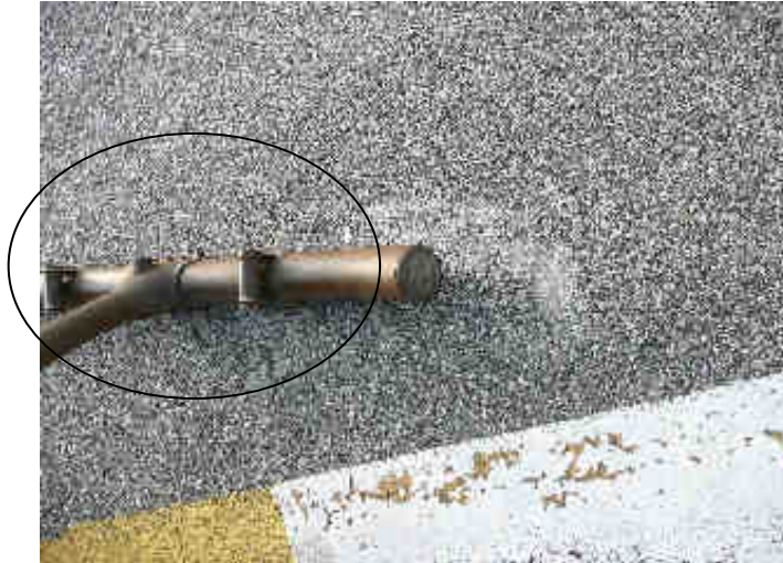
Vue n° 8 : érosion du sol au niveau de l'arrière du patin droit
