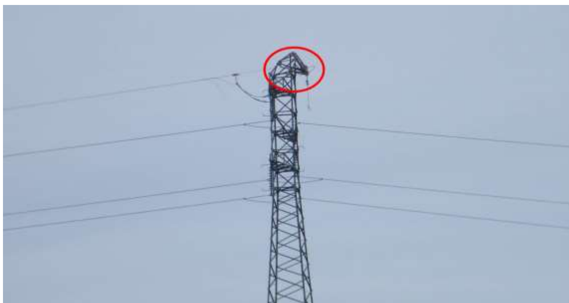
Pylône nord endommagé
