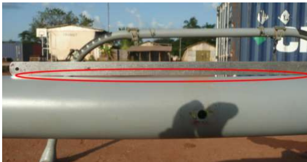
Figure 4 : endommagement de l'arceau droit
