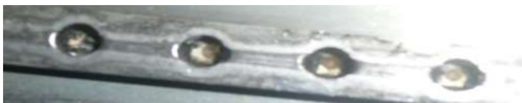
Vue de la détérioration des trous de verrouillage
