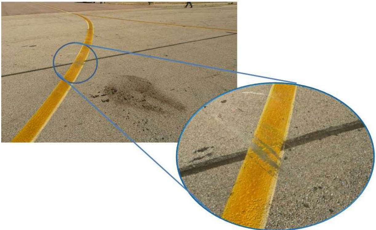
Vue détaillée de la trace de contact du ballonnet droit
