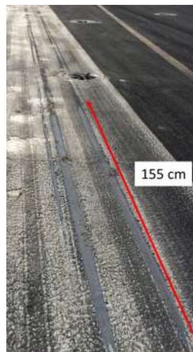
2 ème partie endommagée du pont d'envol
