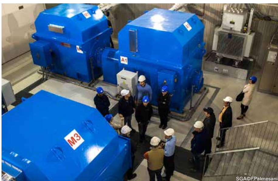
La centrale de conversion Castigneau.
