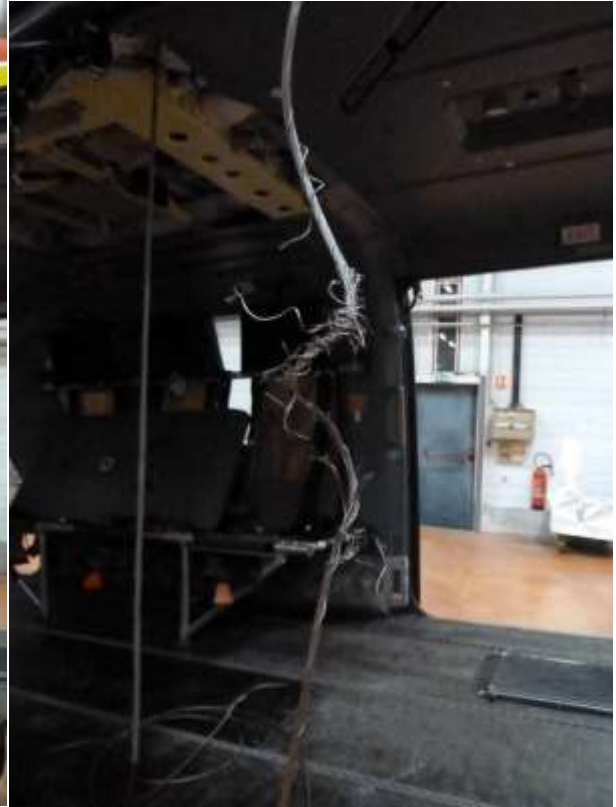
Zoom partie endommagée
