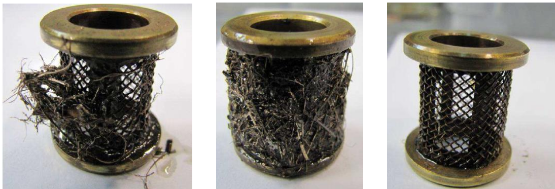
Crépines de récupération des paliers turbine HP, intermédiaire et arrière
