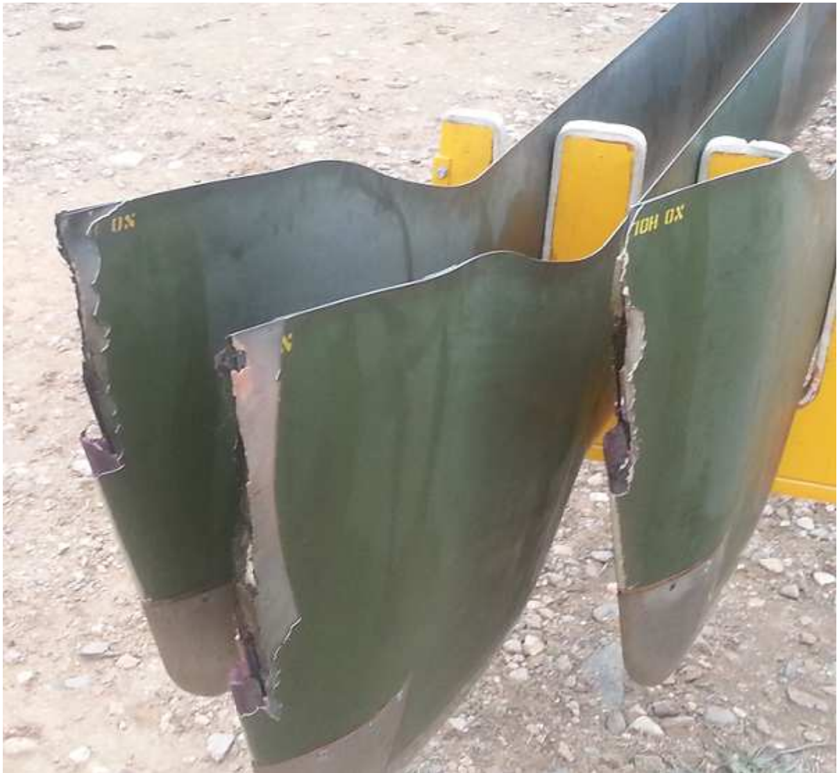
Vue des dommages sur trois des quatre pales
