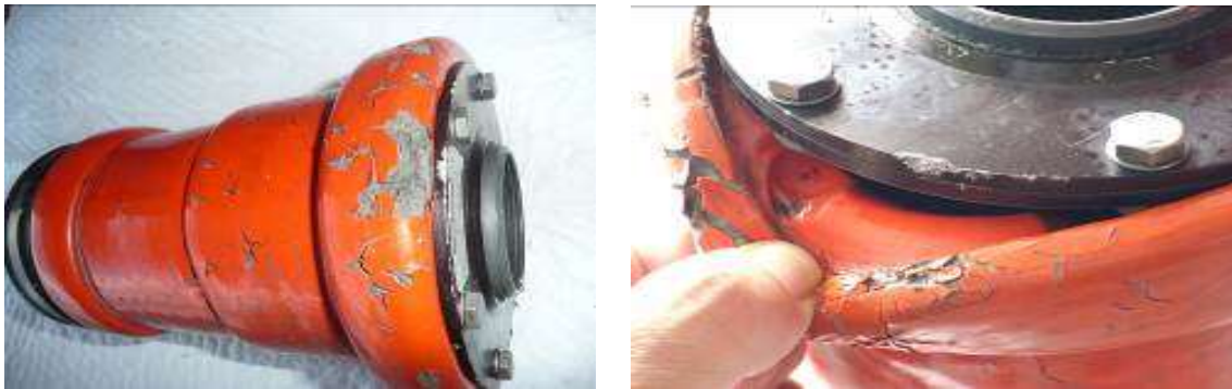
Dégâts sur le crochet de treuil
