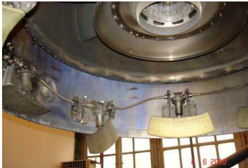
Ensembles DSV détériorés
