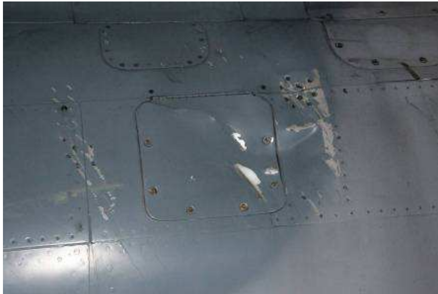
Détails des endommagements de la zone 28-10
