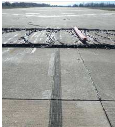
Détail de la trace laissée par le pneumatique de la roue du train principal droit
