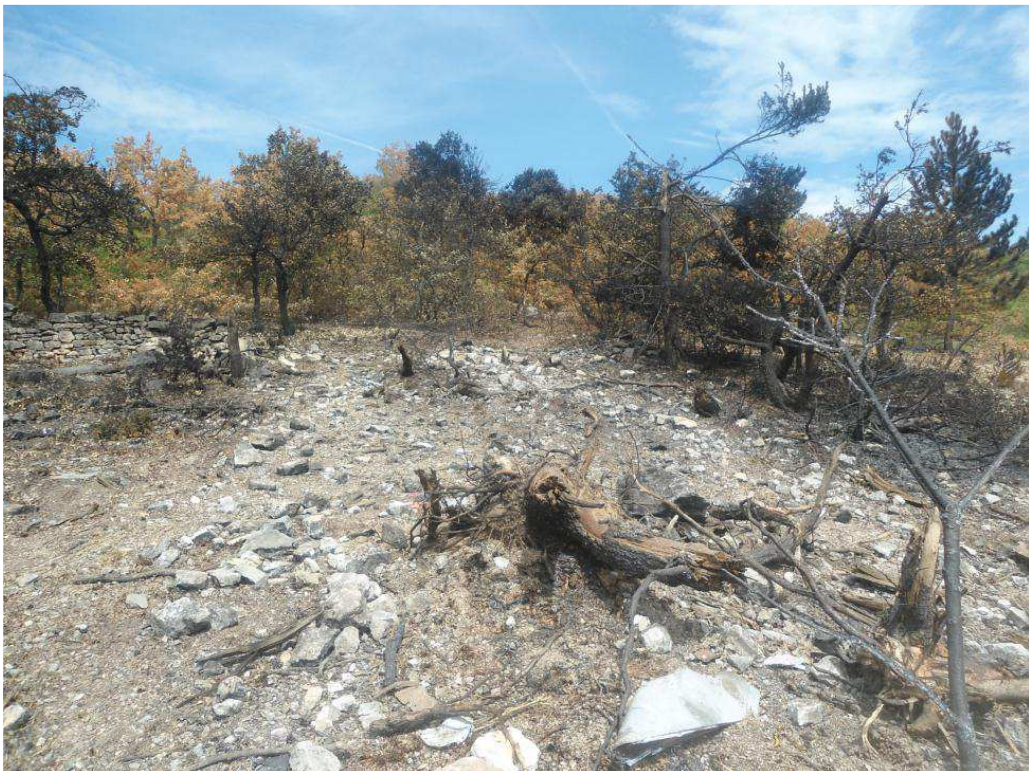
Vue du second impact sur le mur en pierre sèche
