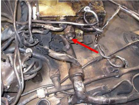
Rupture entrée PFT
