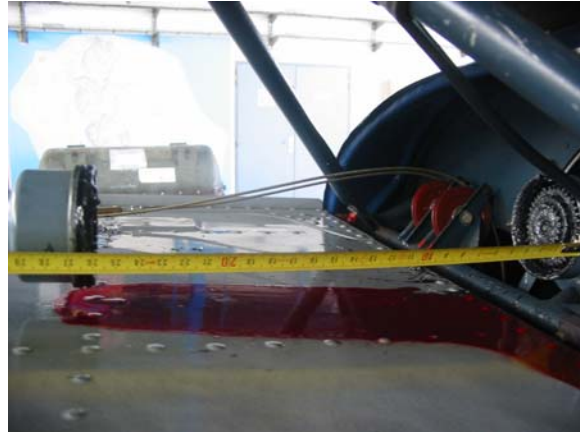
Désaccouplement au niveau de la cloche avant et recul de l'arbre
