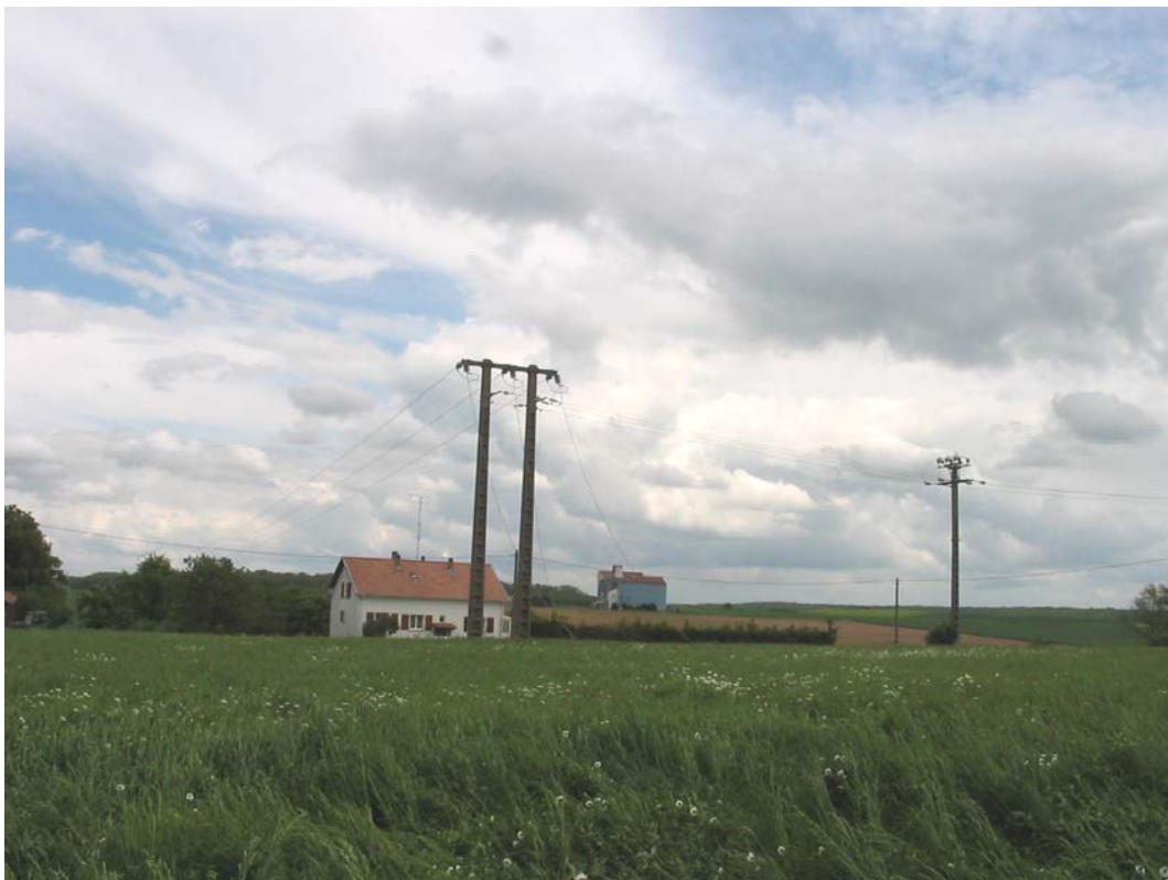
Vue de la ligne MT sectionnée.
