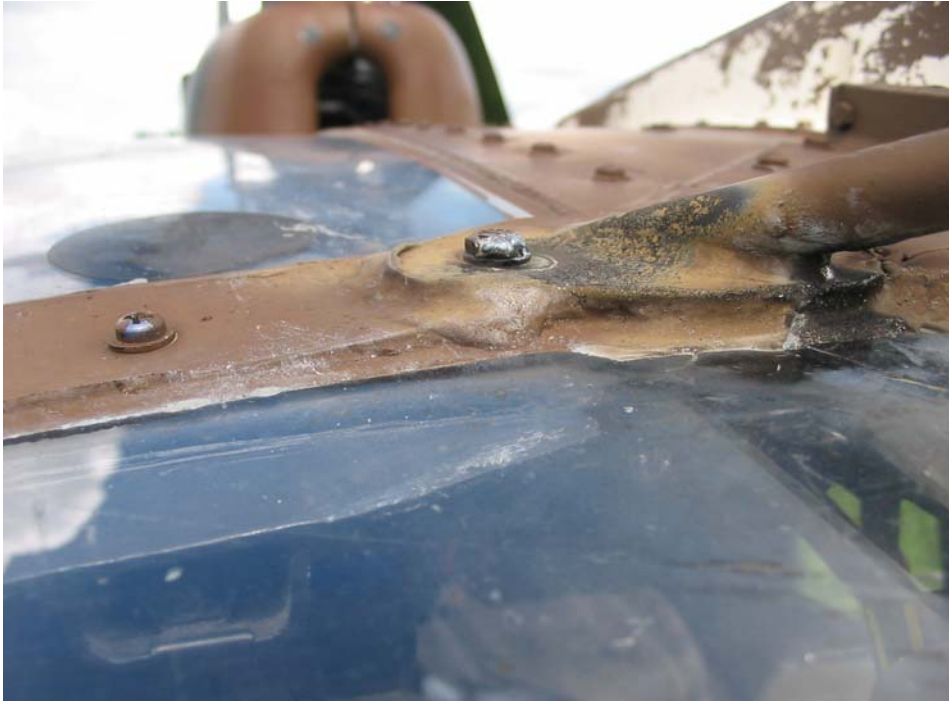
Arc électrique sur tête de vis de fixation droite coupe câble.
