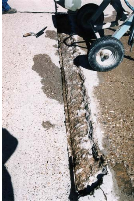
Vue de la dalle endommagée
