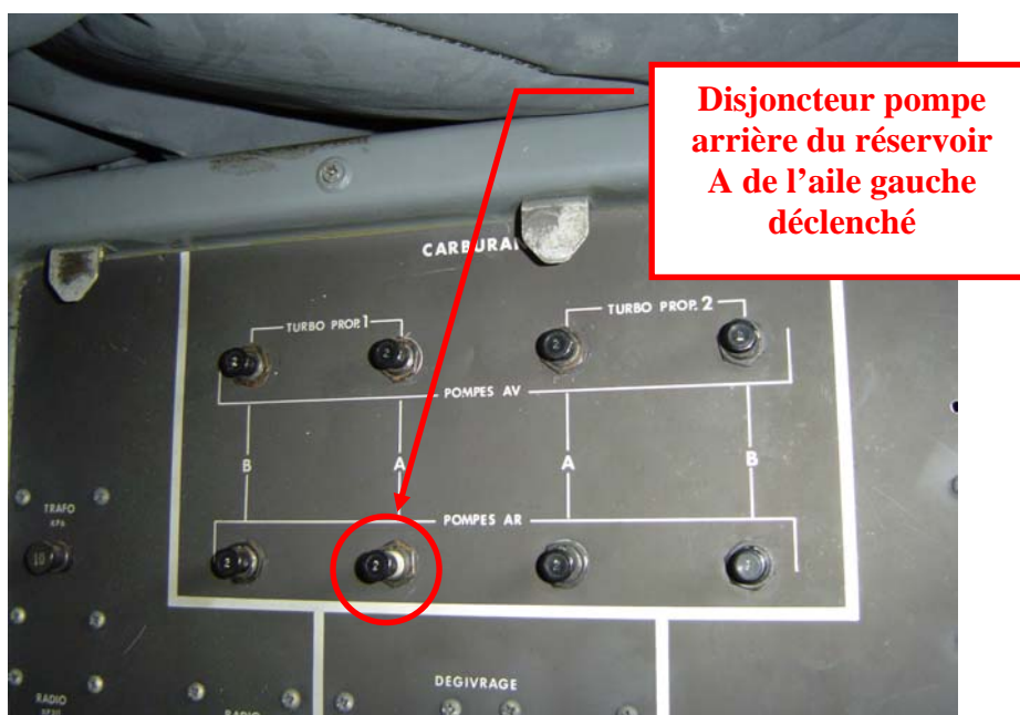
Position des disjoncteurs des huit pompes carburant
