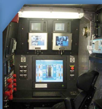
Poste de contrôle machines
