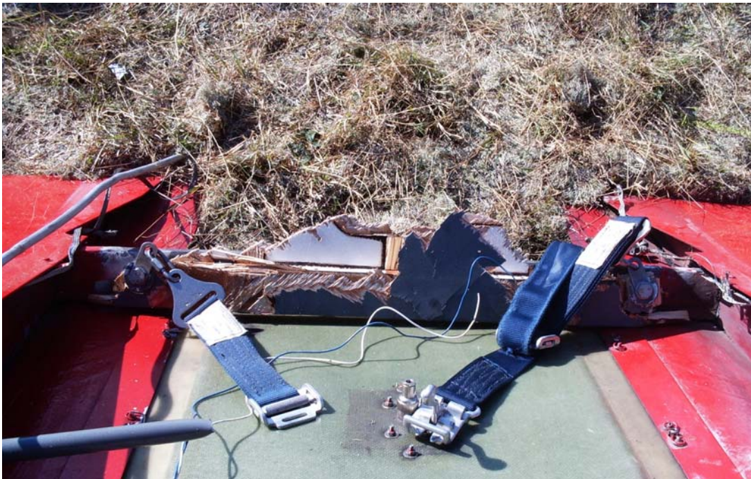
Détail de la rupture du cadre 3 (arrière)
